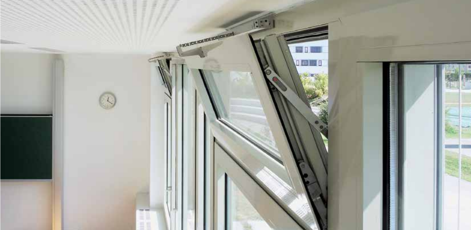
Geöffnete Oberlichten einer freien natürlichen automatischen Fensterschlitzlüftung
